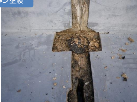
◆ウレタン塗膜防水のコンクリート躯体の劣化 ・カビ発生
