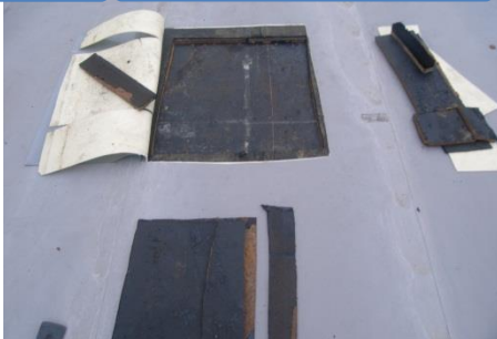
◆アスファルト防水(断熱材入り)の上に塩ビシート絶縁防水を 施工。コンクリート躯体に多量の水分・カビ発生。
