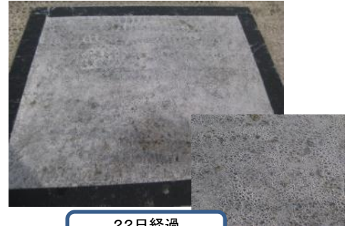
22日経過 多量の結露が発生
