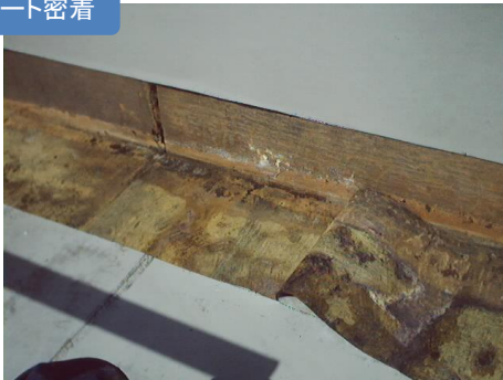
◆塩ビシート密着防水のコンクリート躯体の劣化 ・カビ発生
