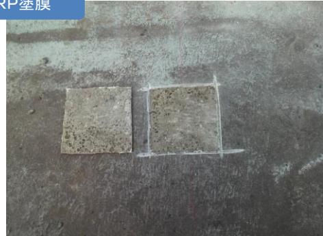
◆FRP密着防水のコンクリート躯体内部の水分(スラブ面が濡れている)
