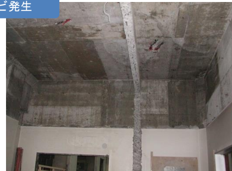
◆左記現場の室内側コンクリートの表面。大量のカビが発生。
