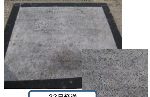
22日経過 多量の結露が発生
