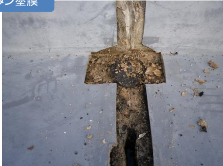
◆ウレタン塗膜防水のコンクリート躯体の劣化 ・カビ発生
