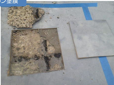
◆ウレタン塗膜防水のコンクリート躯体の劣化
