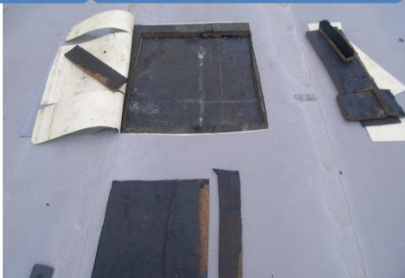
◆アスファルト防水(断熱材入り)の上に塩ビシート絶縁防水を施工。コンクリート躯体に多量の水分・カビ発生。
