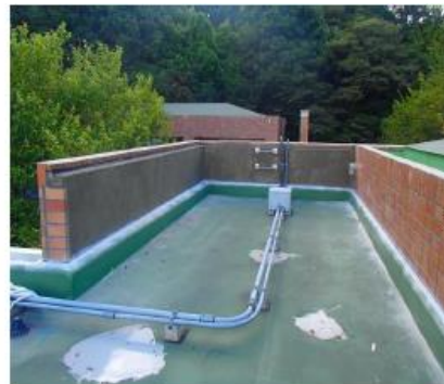
件名: 屋上防水改修工事 (標本倉庫上部) 部位: 屋上 内容: 塗装工事 施工前 下地調整完了
