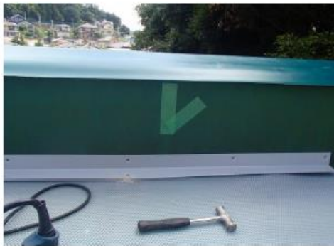
件名: 屋上防水改修工事 (標本倉庫上部) 部位: 屋上 内容: 防水工事 既存防水膨れ部是正 完了
