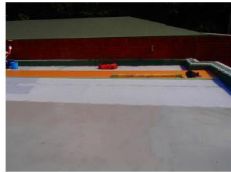
件名: 屋上防水改修工事 (標本倉庫上部) 部位: 屋上 内容: 防水工事 コアコーン敷き込み 断熱材敷き込み
