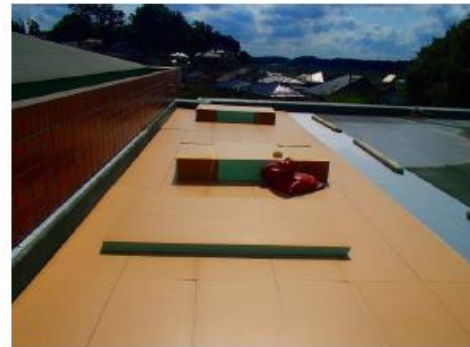
件名: 屋上防水改修工事 (標本倉庫上部) 部位: 屋上 内容: 防水工事 コアコーン敷き込み 断熱材敷き込み
