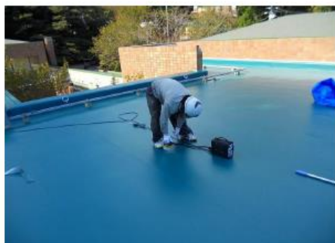
件名: 屋上防水改修工事 (標本倉庫上部) 部位: 屋上 内容: 防水工事 圧着状況
