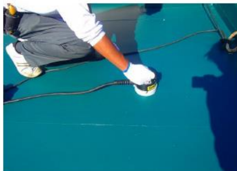
件名: 屋上防水改修工事 (標本倉庫上部) 部位: 屋上 内容: 防水工事 圧着状況
