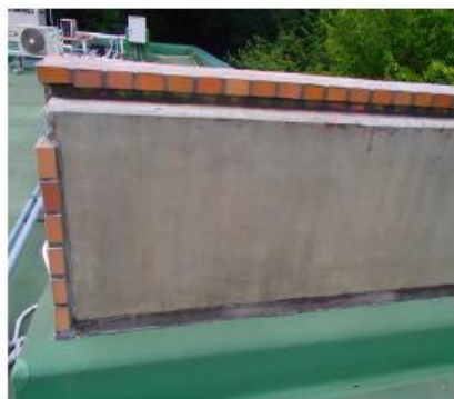
件名: 屋上防水改修工事 (標本倉庫上部) 部位: 屋上 内容: 塗装工事 施工前
