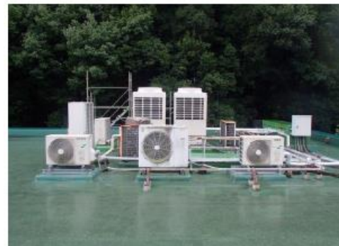
件名: 屋上防水改修工事 (標本倉庫上部) 部位: 屋上 内容: 防水工事 施工前
