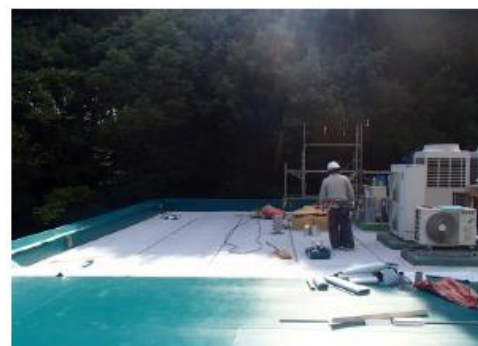
件名: 屋上防水改修工事 (標本倉庫上部) 部位: 屋上 内容: 防水工事 コアコーン敷き込み状況
