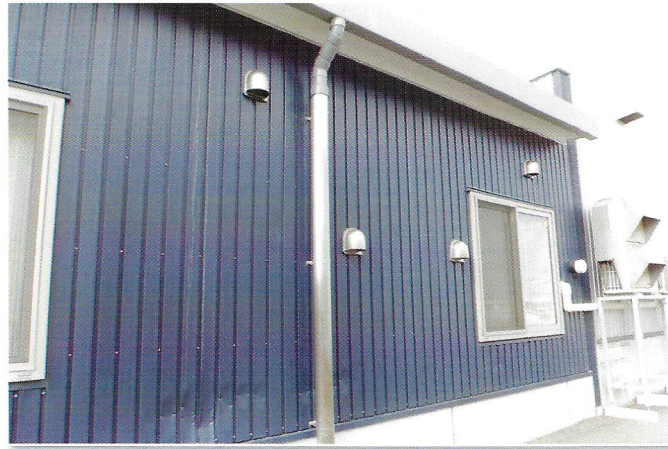
北海道石狩事務所棟(排水管長:4m)
