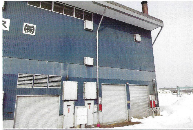
北海道石狩事務所棟(排水管長:15m)
