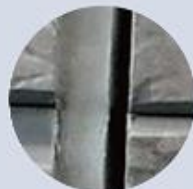
シーリングの切れ
