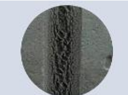
シーリングの凝集破壊
